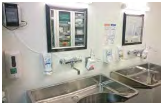
Rigg for våt vask. Ozonapparat opp til venstre. Miksar i enden av kranen.
